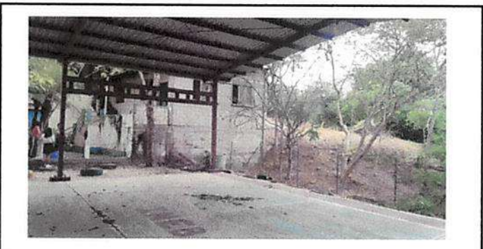
Foto 5: Malla perimetral en mal estado.
