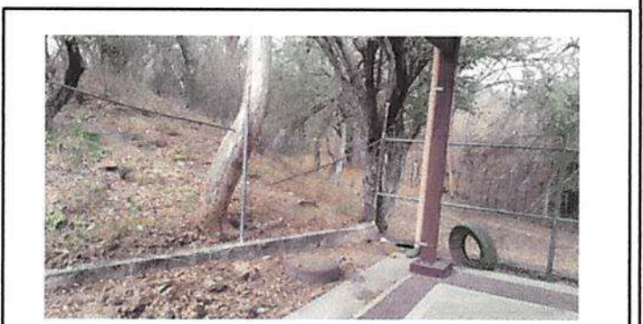
Foto 6: Malla perimetral deteriorada.
