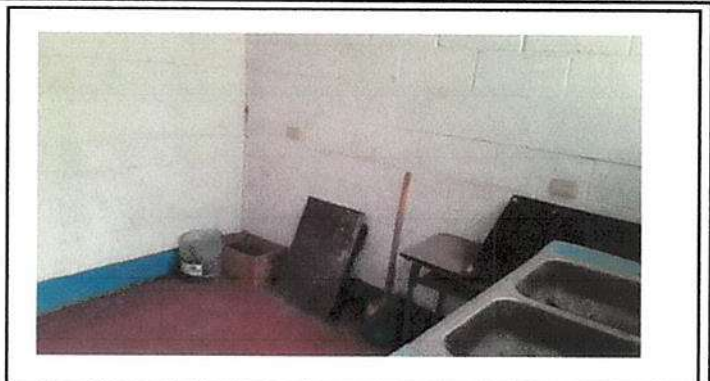
Foto 2: Cocina en mal estado.
